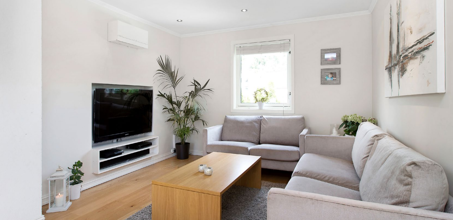
Miniventilasjon montert i stuen
